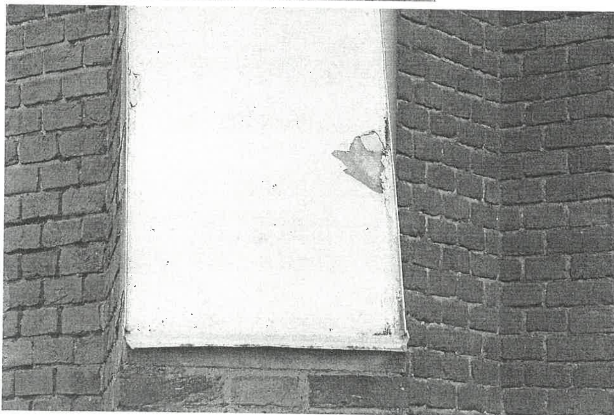
Fot. Nr 22 i 23. Kościół parafialny p.w. Św. Mikołaja biskupa w Równem. Stan przed konserwacją.
