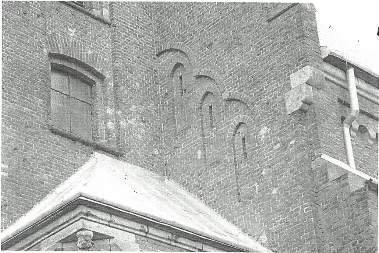
Fot. Nr 17 i 18. Kościół parafialny p.w. Św. Mikołaja biskupa w Równem. Stan przed konserwacją.
